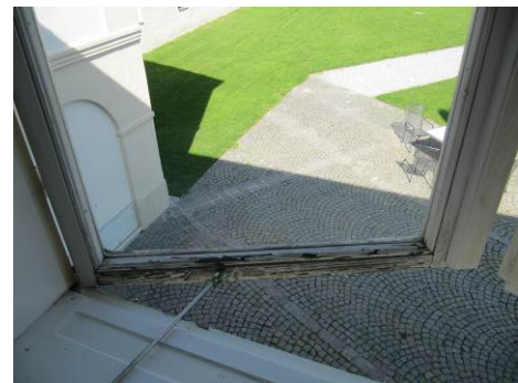
Schadhafter Fensterflügel Südfassade
