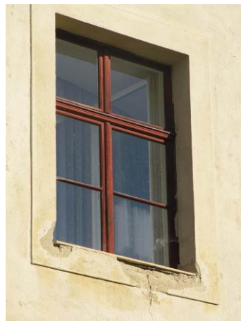
Schadhafter Verputz Ostfassade
