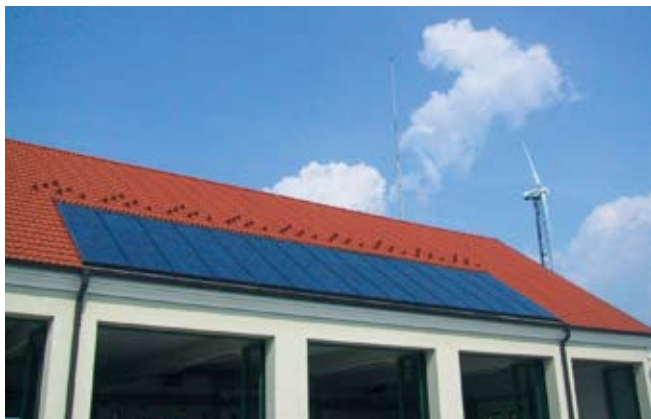
Links: Photovoltaikanlage der Straßenmeisterei Zistersdorf
