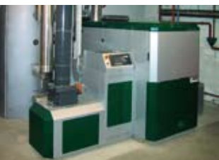
Straßenmeisterei Gloggnitz Pelletsanlage 150 kW
