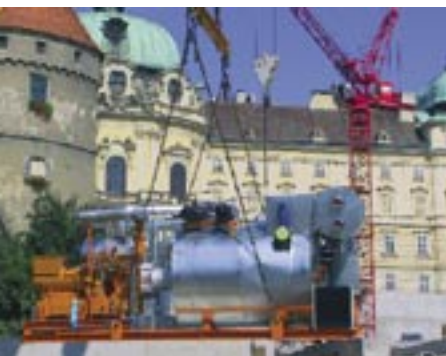
Anlieferung des ORC-Moduls im Stift Klosterneuburg
