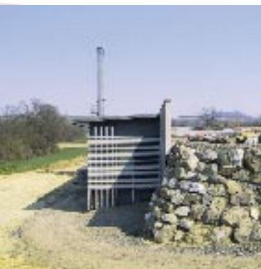
Biomasse Fernheizwerk Melk
