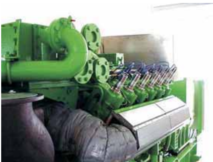
BHKW Krankenhaus Zwettl
