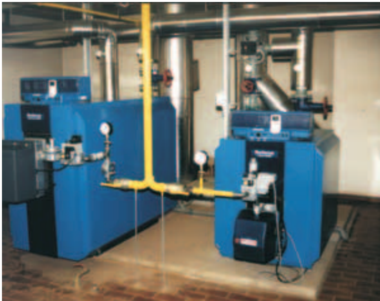
Straßenmeisterei Langenlois, Wärmeerzeugungsanlage
