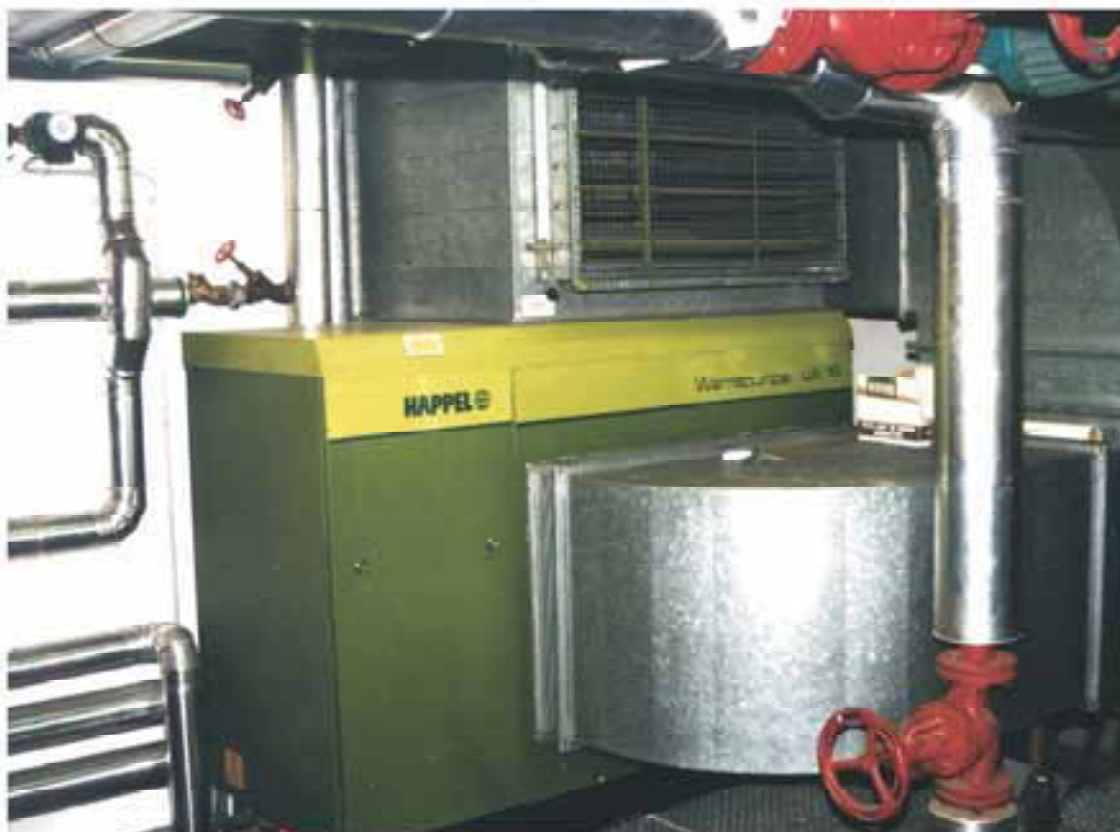
Wärmepumpe Straßenmeisterei Retz
