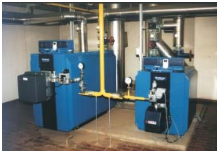
Straßenmeisterei Langenlois, Wärmeerzeugungsanlage
