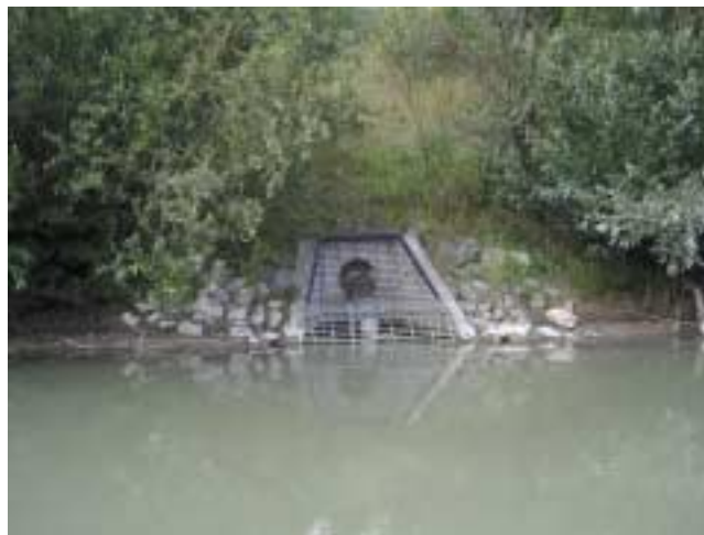
Wasserentnahmebauwerk am Marchfeldkanal zur Feldberegnung
