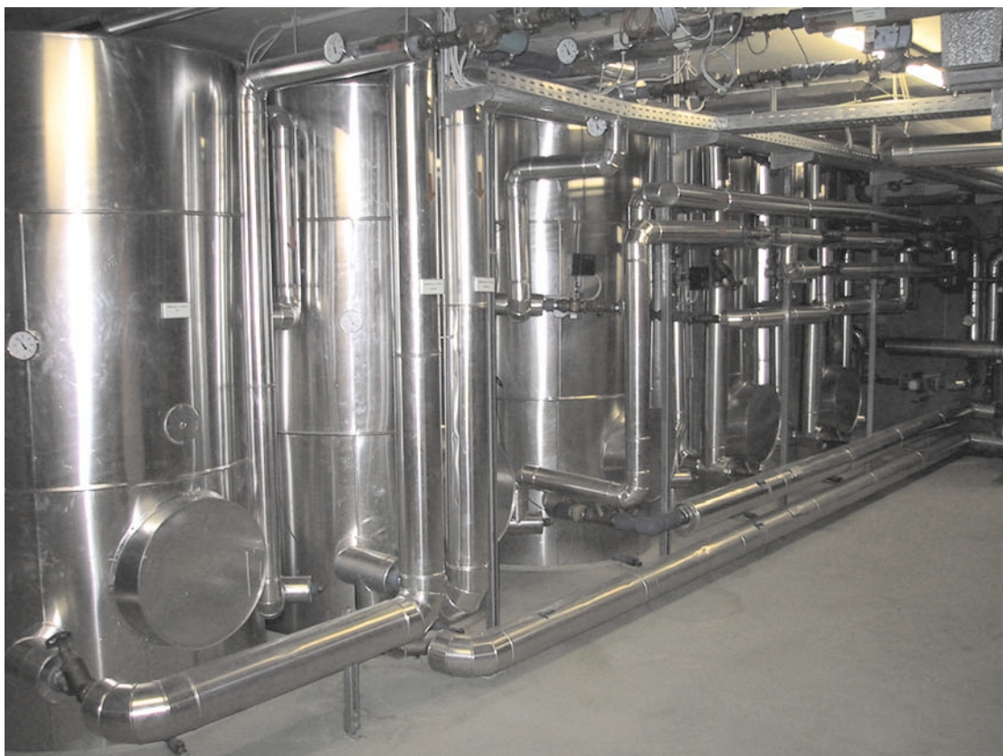
Solarboiler im Landespensionistenheim Laa an der Thaya
