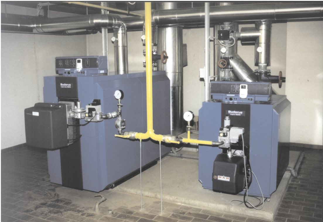
Straßenmeisterei Langenlois, Wärmeerzeugungsanlage
