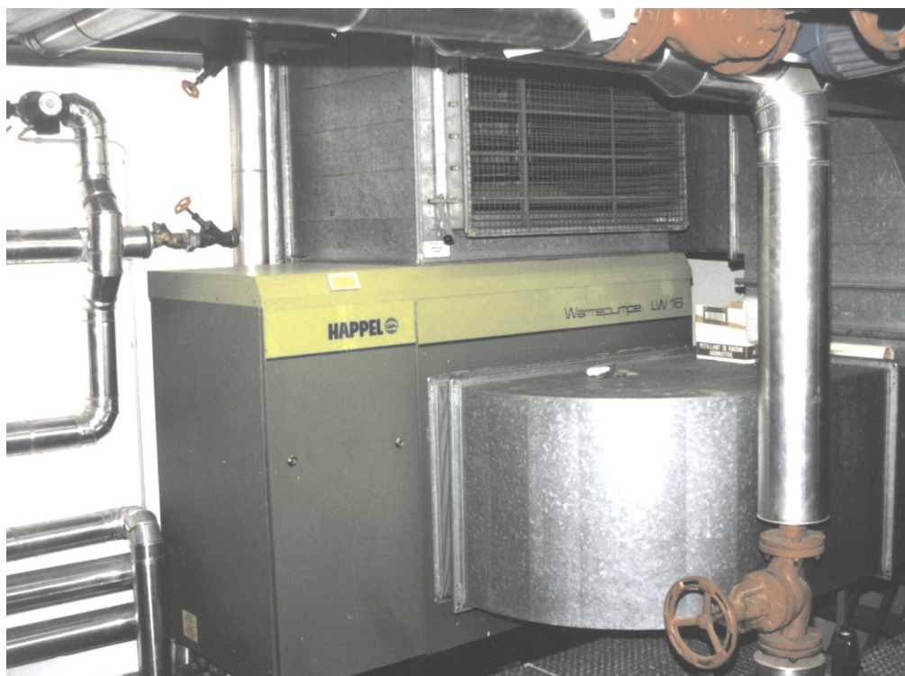
Wärmepumpe Straßenmeisterei Retz
